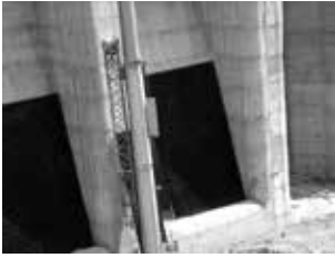
Devecikonağı HES Izgara
