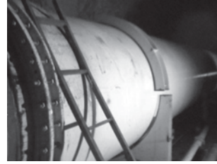
Arpa HES Cebri Boru L = 870 m \phi = 2 m
