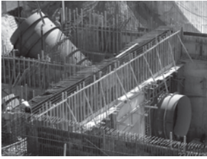
Devecikonağı HES Cebri Boru \phi = 4200 m
