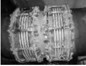
Paşa HES Cebri Boru, Esnek Conta
