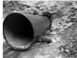
Kayaköprü 1 HES Sürme Boru
